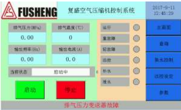
图 10-24 主界面故障显示
