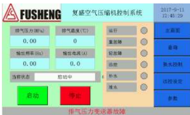
图 10.24 主界面故障显示
